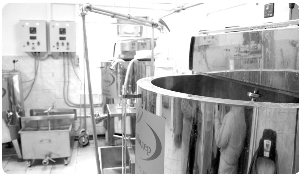
Новое оборудование готово к работе
